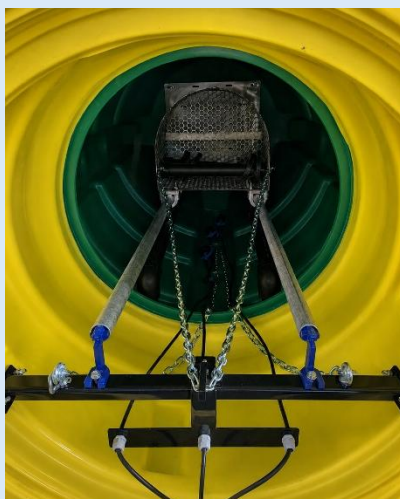
Figura 01 - Vista superior do tanque — pedestal com tubos guia e chaves boia instalados.
